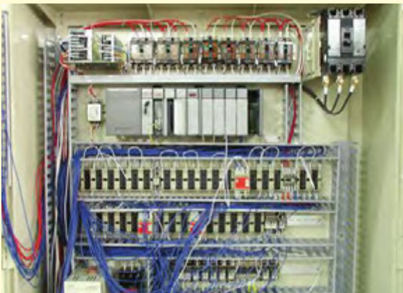
フリーレール システムによる制御盤製作例
